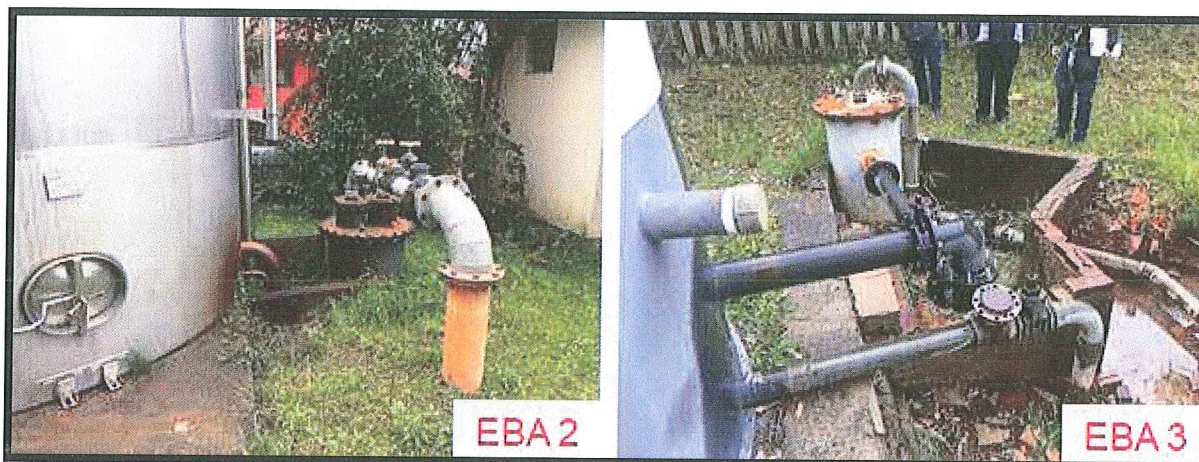
Figura 5: Vista das Estações de Bombeamento
