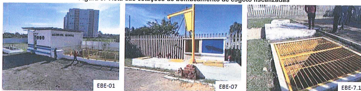
Figura 8: Vista das estações de bombeamento de esgoto fiscalizadas
