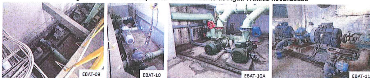
Figura 6: Vista das Estações de Bombeamento de Água Tratada fiscalizadas
