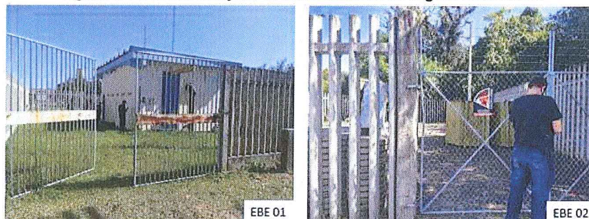
Figura 3: Vista das estações de bombeamento de esgoto fiscalizadas
