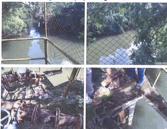
Figura 1: Captação de água Bruta
