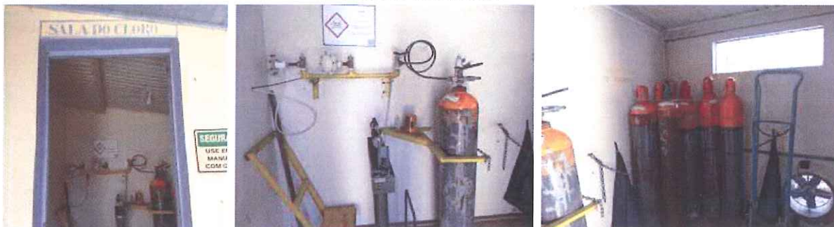
Figura 8: Sala de cloro
