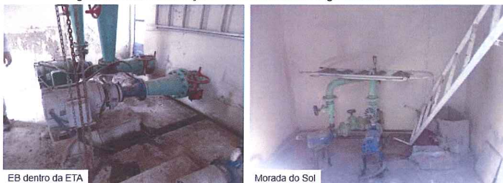
Figura 10: Vista das Estação de Bombeamento de Água Tratada fiscalizadas
