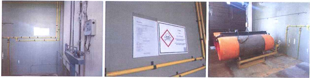
Figura 6: Sala de cloro
