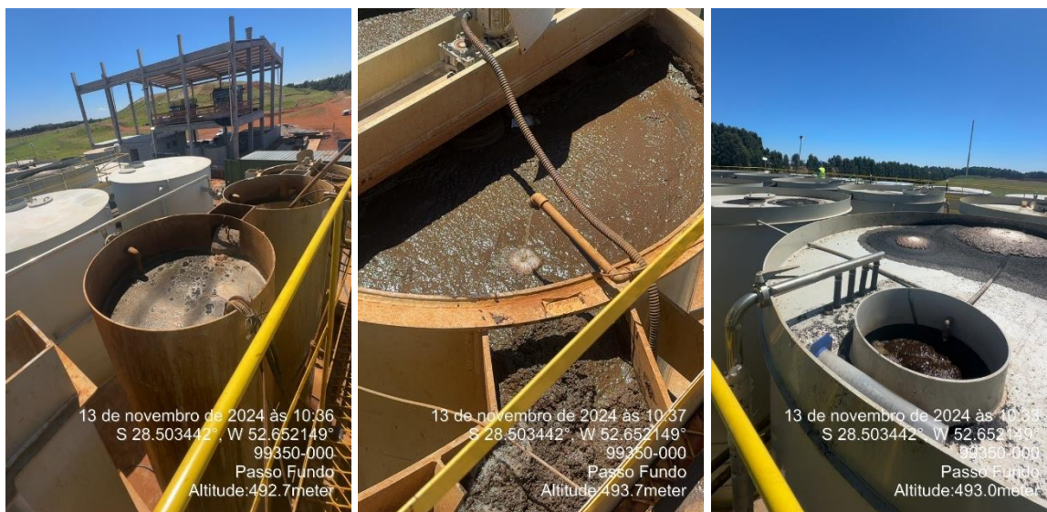
Figura 7: Estação de tratamento de efluentes da CRVR – Victor Graeff
