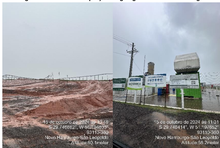
Figura 7: Sistema de captação de gás gerado e usina de biogás
