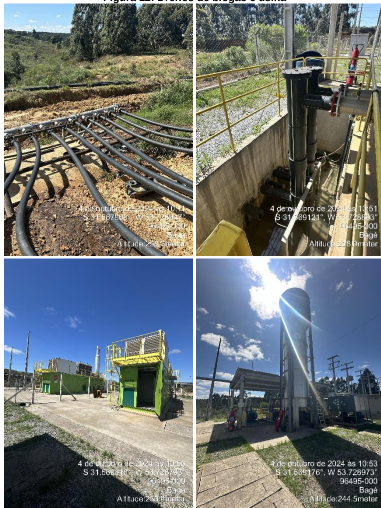
Figura 12: Drenos de biogás e usina
